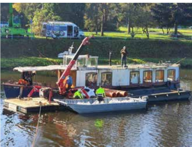
Obr. č. 10 Vyplňování jámy ve dně plavebního kanálu Zdroj: Fotodokumentace stavby TALPA-RPF
