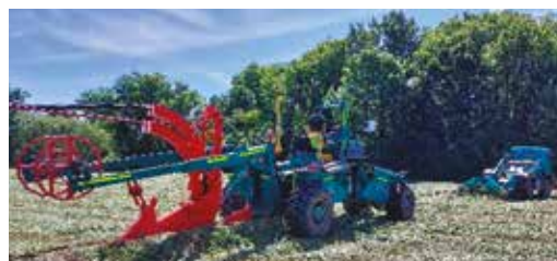
Měření pozice a tažných sil el. kabelu
