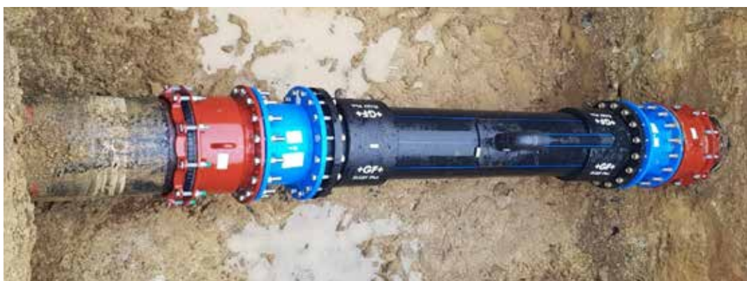
Obr. 8 – Propojení sanačních úseků přírubovými konektory Primus Line R1 s propojem a vývodem vzdušníku provedeným v PE.
